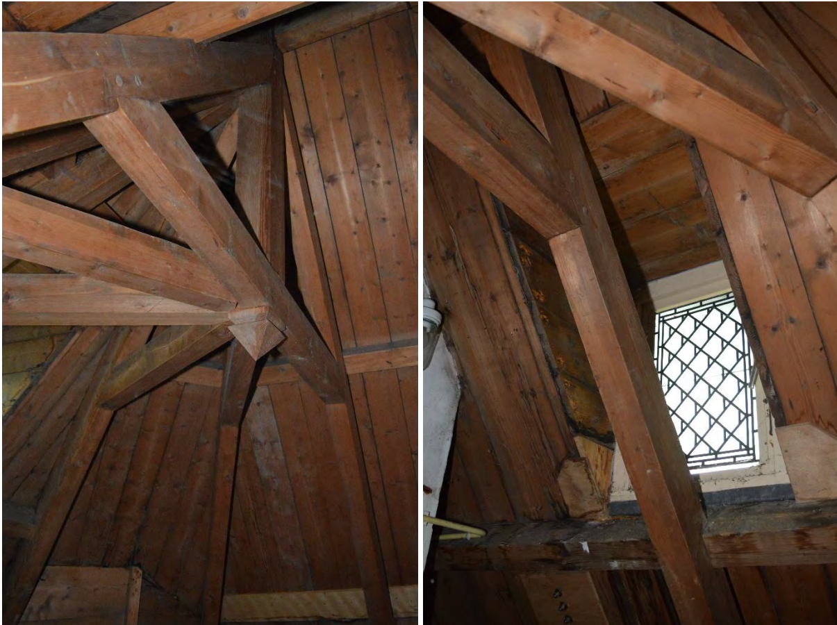
Links: de kapconstructie van de zuidelijke sacristie van de kapel, bestaande uit een spant en vier waaierend geplaatste halfspanten. Het leibescht is op de muurplaat, gordingen en nokbalk getimmerd. Rechts: een van de kleine dakkapellen op de kap van de zuidelijke sacristie van de kapel, voorzien van een raam met glas-in-lood.
