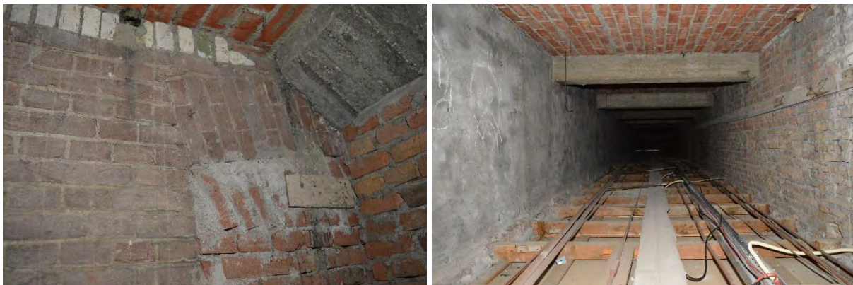
Links: boven het verlaagde plafond van de begane grond in de westvleugel van het nieuwe pensionaat valt de aansluiting op de hoek van het oude pensionaat te herkennen. Dit deel van de gevel heeft nog zijn oude voegwerk. Op de foto is bovendien de anderhalfsteens getoogde rollaag boven het venster te herkennen. Rechts: de ruimte boven het verlaagde plafond van de gang op de begane grond van de noordvleugel van het nieuwe pensionaat. De vloerconstructie van de eerste verdieping bestaat uit betonnen balken en perfora baksteenvloeren (1948). Links op de foto is de beraapte buitengevel zichtbaar, rechts het vuile metselwerk van de gangwand. De loopplank midden onder ligt op de plafondhangers.
